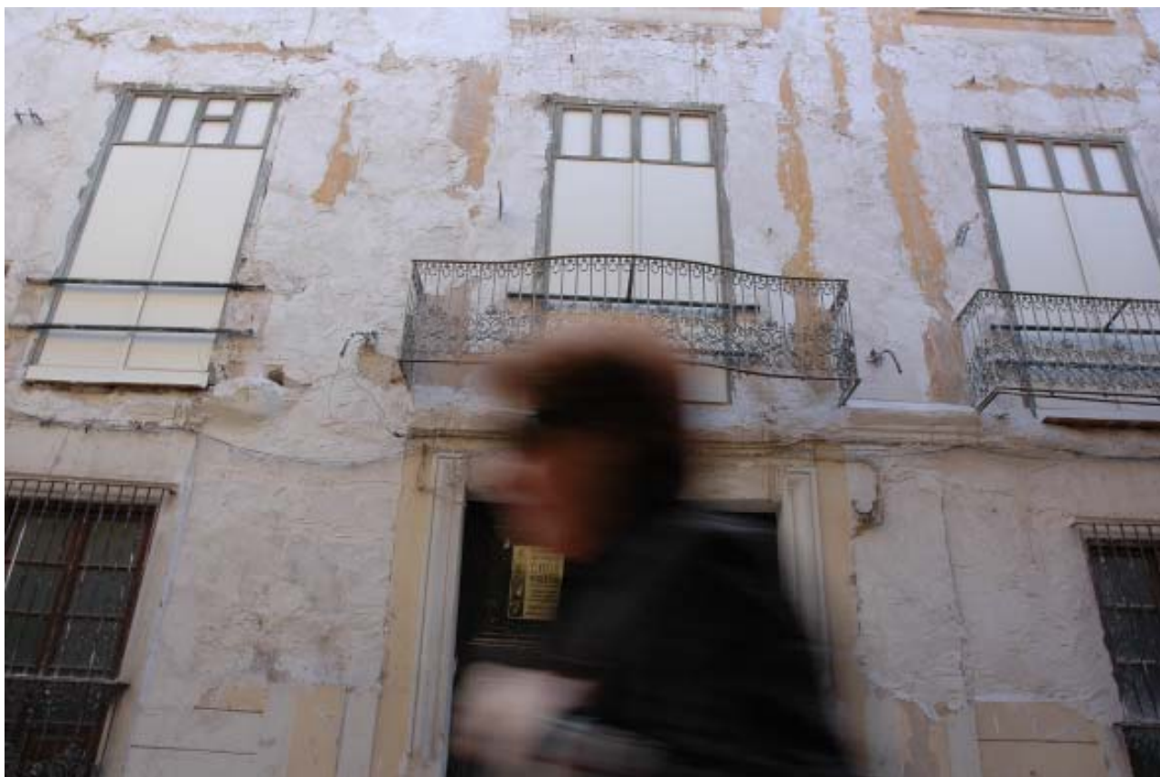
Al carrer Montcada, el palau dels Sanç, d'origen medieval, mostra signes evidents de degradació
