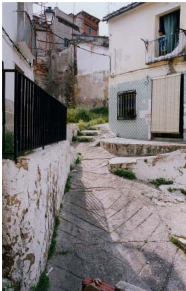
Habitatge precari a la zona dels carrers Santes i Ànimes
